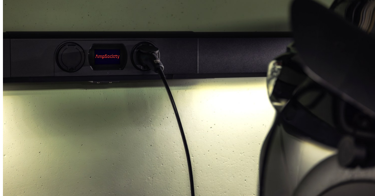
AMP5 Mehrpunkt-Ladesystem in einer Tiefgarage
